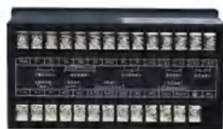
12/24双组配电不供电
